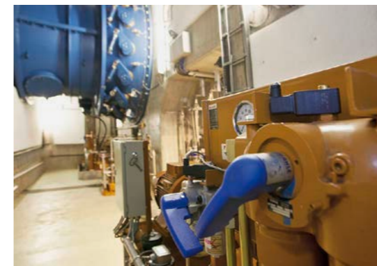
Turbine Kraftwerk Rott
