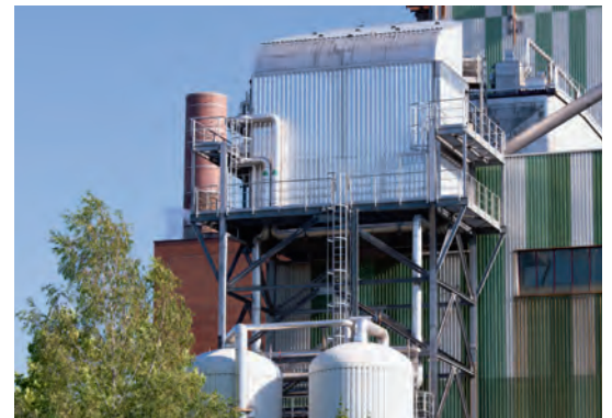
Abwärmeauskopplung der Salzburg AG
