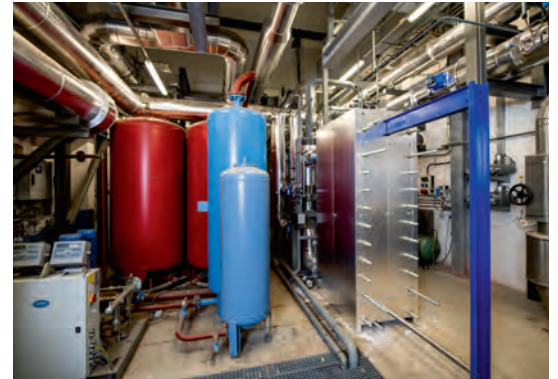
Die 21 Kilometer lange Wärmeschiene verbindet die Fernwärmenetze von Hallein (im Bild die Umformeranlage Elsbethen) und Salzburg miteinander.
